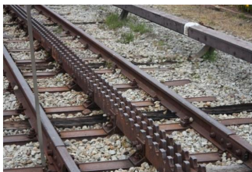
図1: ラックレール
